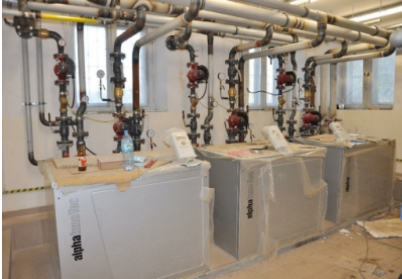
Foto 6. La Bomba de calor en CDR Brwinow
